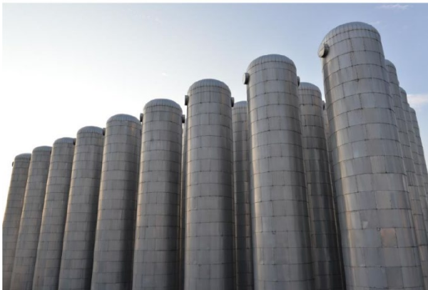
Abbildung 1b: in Reihe sowie parallel geschaltete schlanke Druckbehälter zur Speicherung von Heißwasser im Chemnitzer Fernwärmesystem, Betreiber eins/inet
